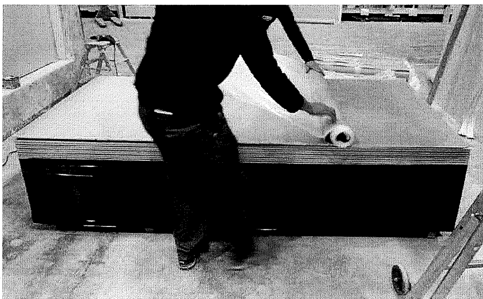
Collage de la membrane à base polymère sur la face arrière de la BA 13
